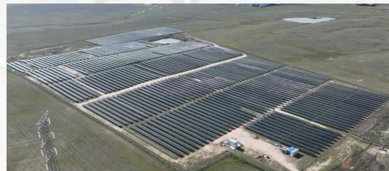
Calzada de Oropesa 7.6 MW PV Plant Castilla y La Mancha, Toledo
