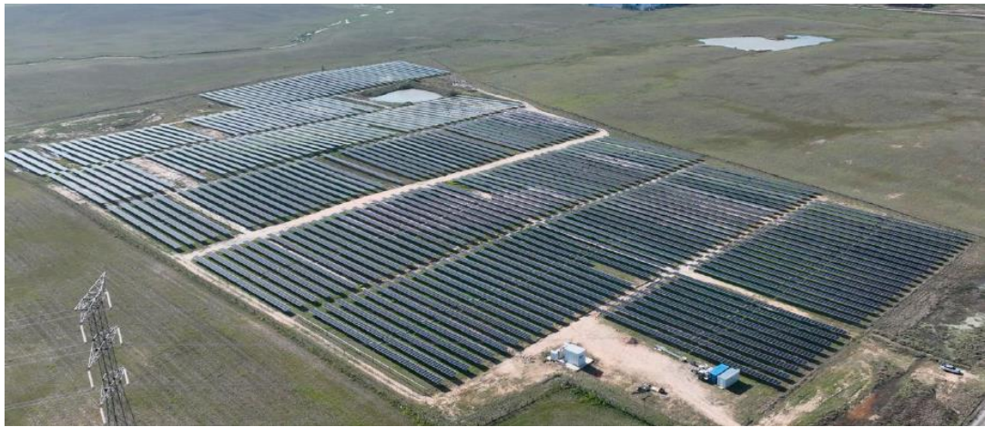
Calzada de Oropesa. 7.6MW photovoltaic generation park in Castilla y la Mancha, Toledo.
